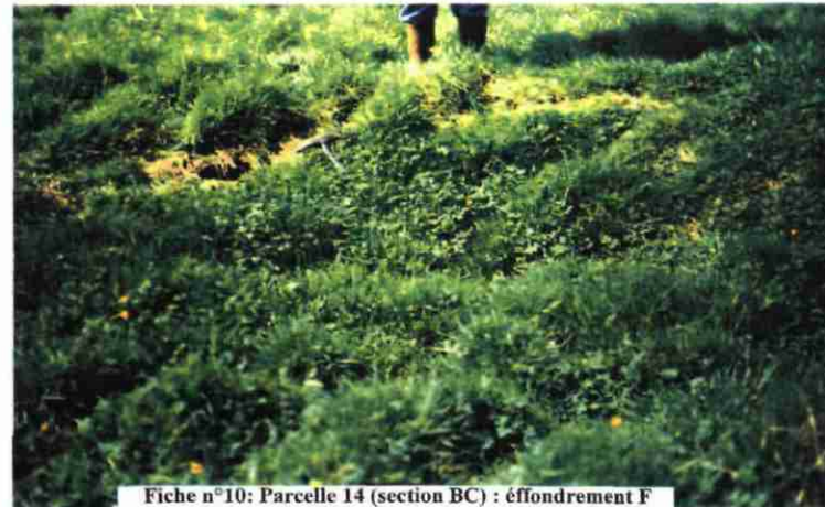
Fiche n°10: Parcelle 14 (section BC) : éffondrement F
